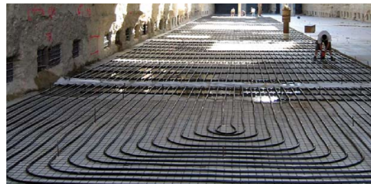
Erdwärmekollektoren unter der Bodenplatte (Quelle: iC consulenten)
